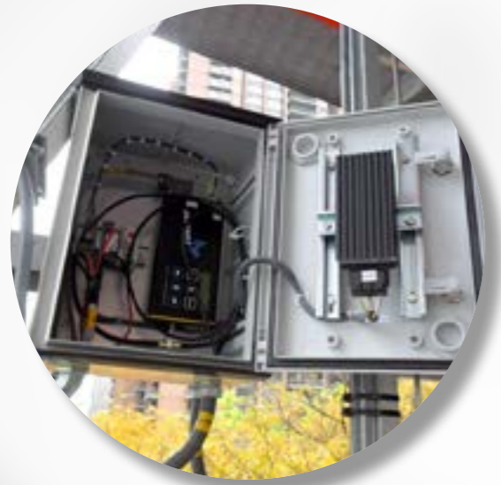
1. Die Richtantennen des DATAEAGLE Classic 3702A Master am Schaltschrank an einem Mast.
