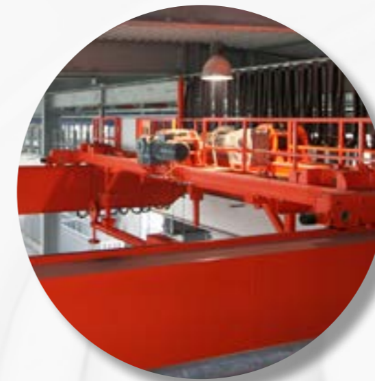
1. Die Krankatze in der Verzinkungsanlage empfängt und sendet Daten über den DATAEAGLE Slave.
