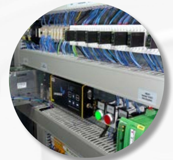
2. Der DATAEAGLE 3000 Master im Schaltschrank kommuniziert bis heute zuverlässig mit der Kabine.
