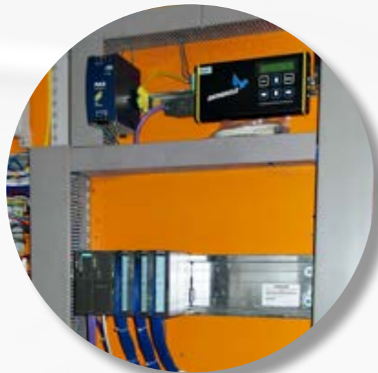
2. Der DATAEAGLE Master im Schaltschrank.
