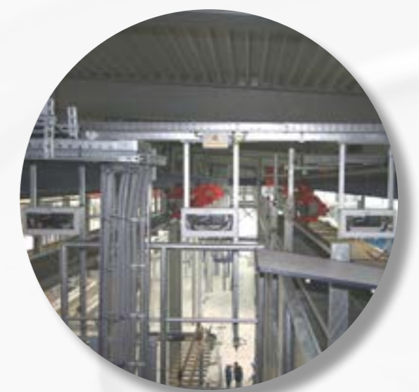
2. Der DATAEAGLE sitzt direkt in der Deckenkonstruktion und ist die Basisstation (Master).
