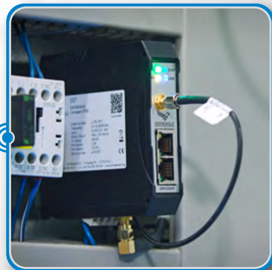
DATAEAGLE im Schaltschrank
