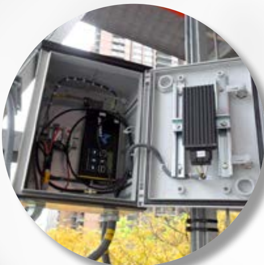
1. Die Richtantennen des DATAEAGLE Classic 3702A Master am Schaltschrank an einem Mast.
