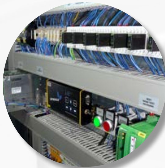
2. Der DATAEAGLE 3000 Master im Schaltschrank kommuniziert bis heute zuverlässig mit der Kabine.
