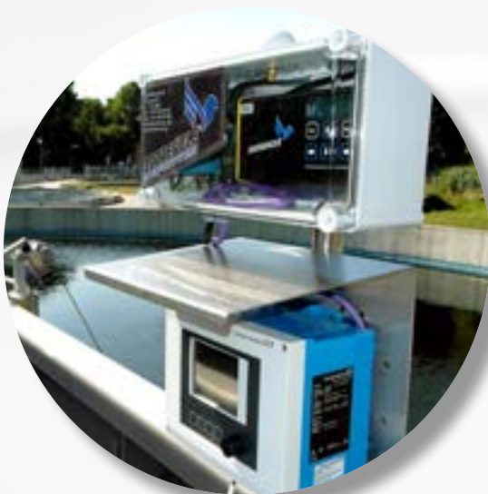
1. Der DATAEAGLE Slave im Außeneinsatz, direkt am Klärbecken.
