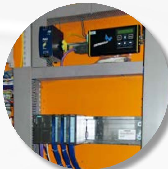
2. Der DATAEAGLE Master im Schaltschrank.
